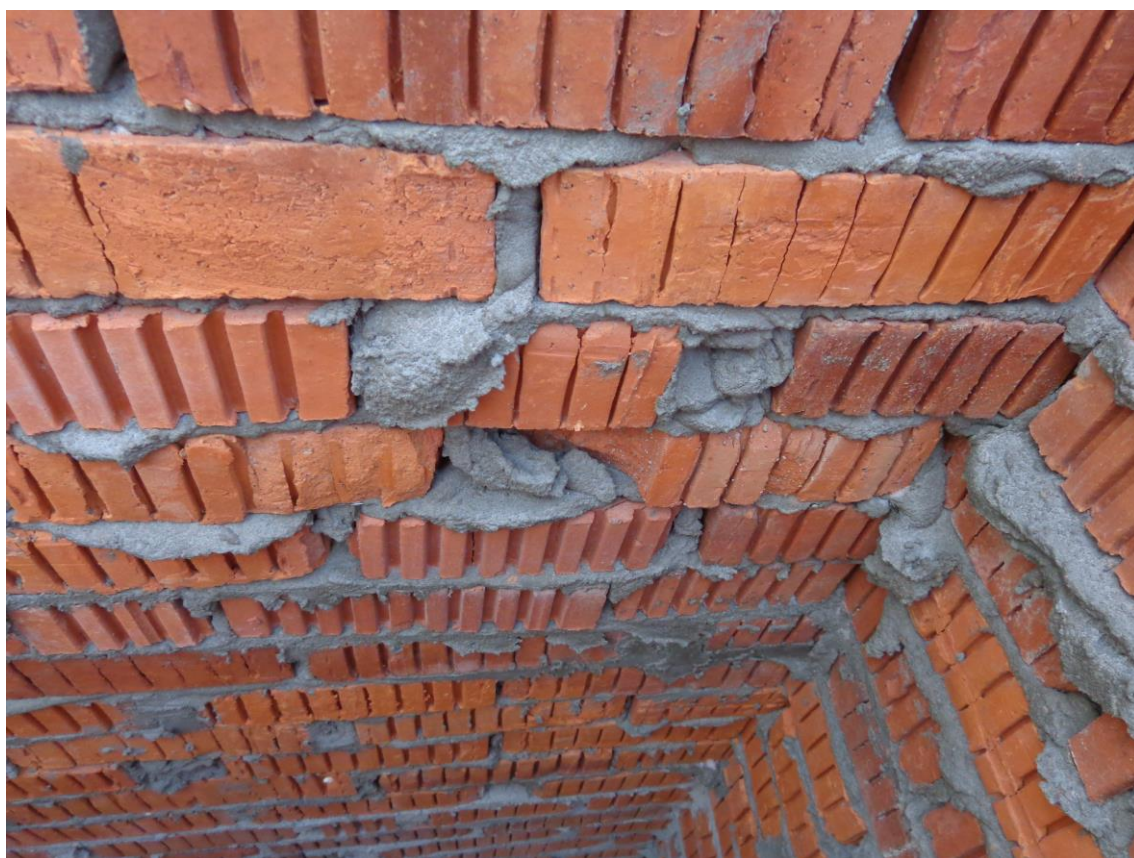
Низкое качество кладки, отсутствие перевязки, наплывы раствора, не заполненные раствором швы.
