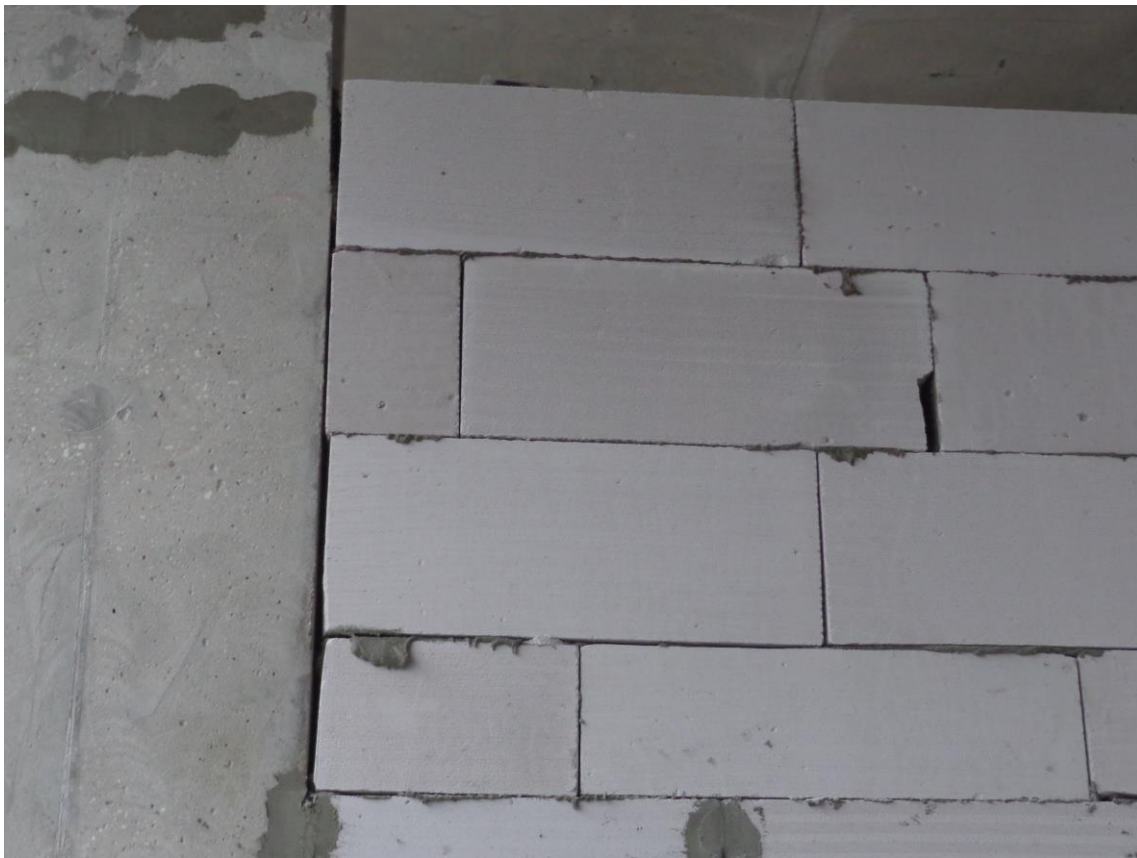
Низкое качество кладки, не заполнены раствором швы.
